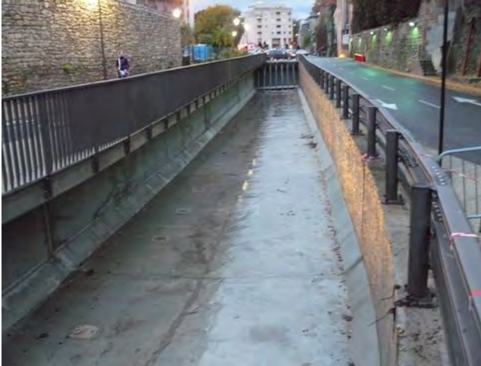
Aménagement d'un cadereau à Nîmes, dans le cadre du PAPI en cours. L'ouvrage a parfaitement fonctionné à l'automne 2014.
